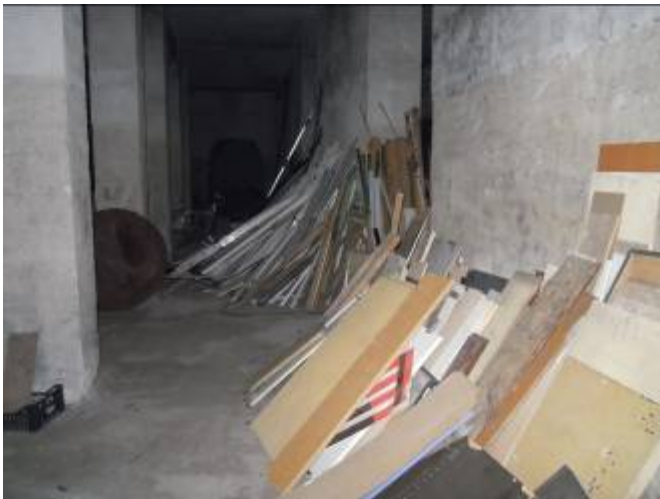
Edificio 04 PL – Scarti di materiale
