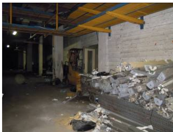
Edificio 11 MO – Scarti di materiale
