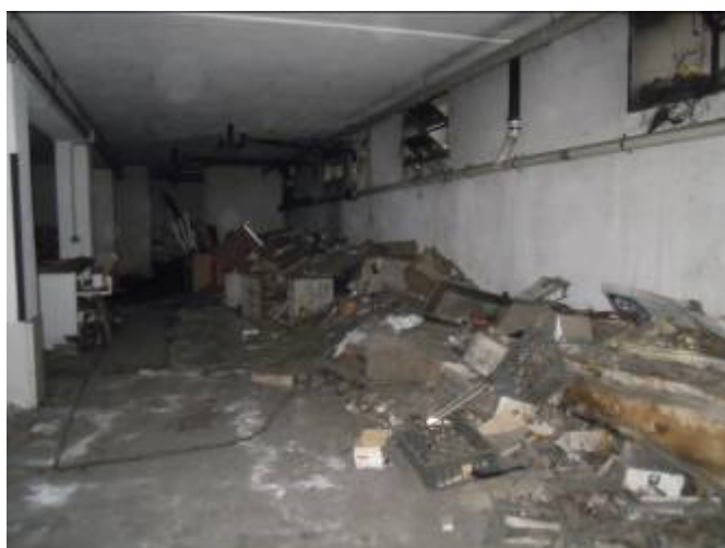
Edificio 10 MO - Macerie
