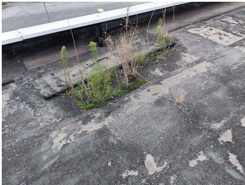
Dettaglio: presenza di vegetazione ed eccessiva usura della guaina
