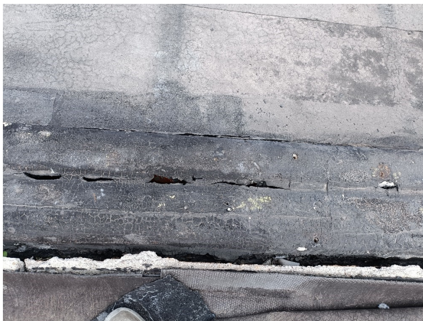
Dettaglio: fessurazione della guaina della copertura alta, fronte sud
