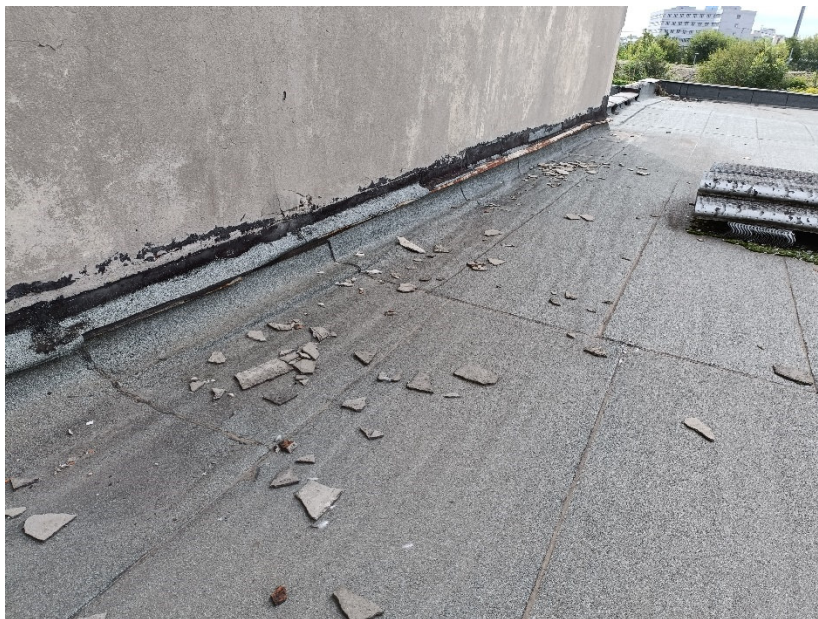
Dettaglio: distacco di porzioni di intonaco in corrispondenza dei risvolti verticali, copertura intermedia porzione sud-ovest
