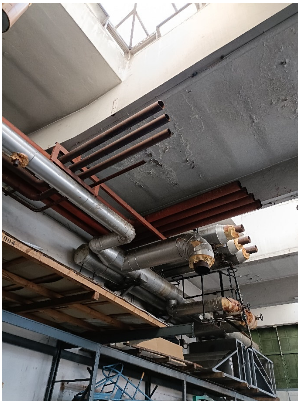
Dettaglio cupolino, segni di infiltrazione a soffitto e lungo la parete
