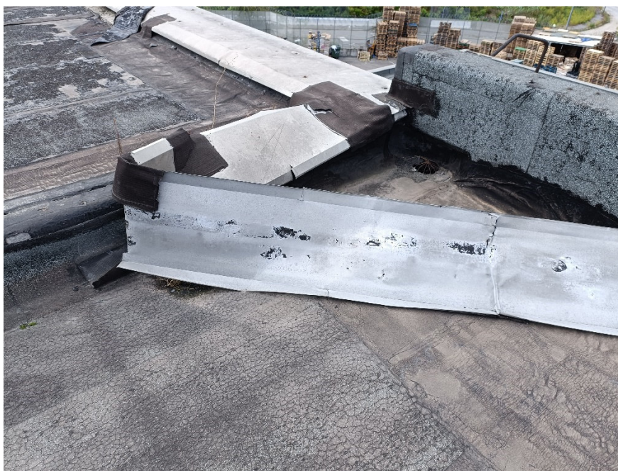
Dettaglio: scossalina divelta in corrispondenza della copertura alta, fronte sud
