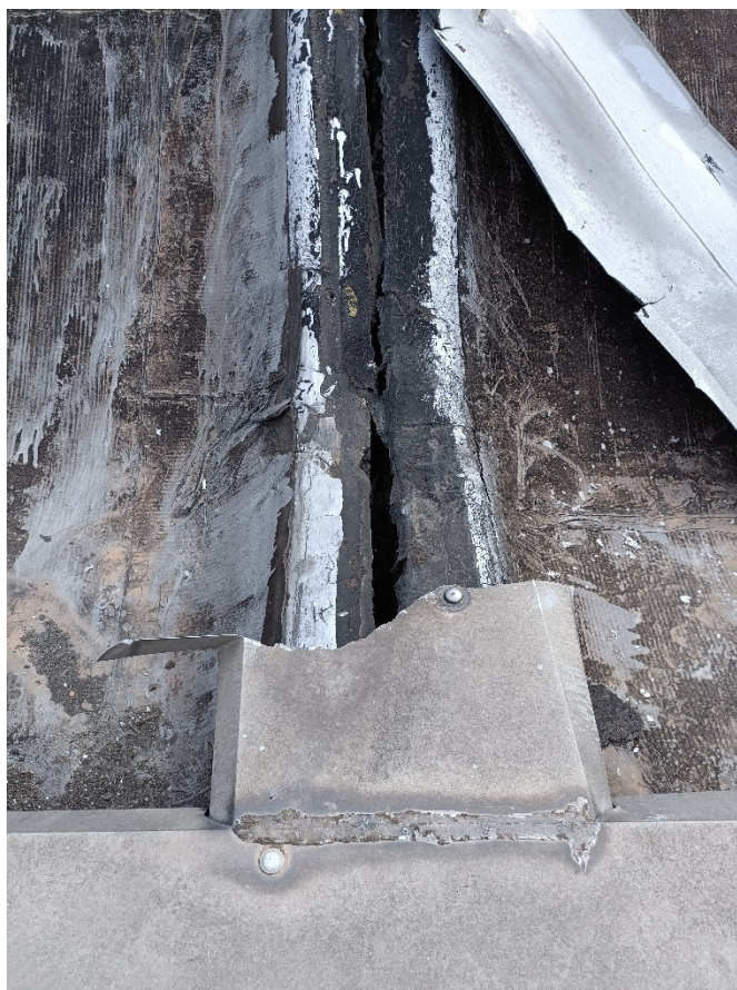
Dettaglio: scossalina divelta e rotta in corrispondenza delle cupole
